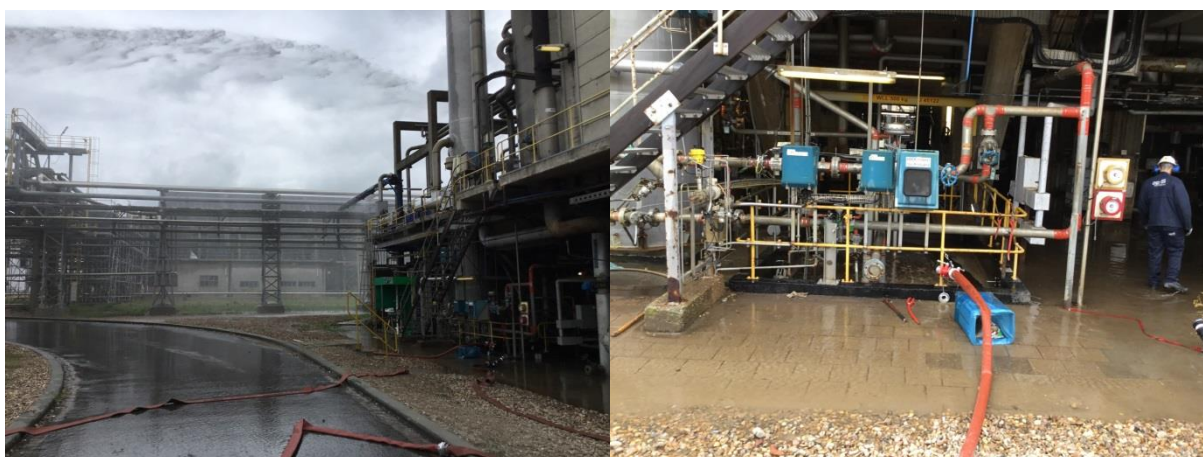
Figuur 1 foto's van betreffende installatie
