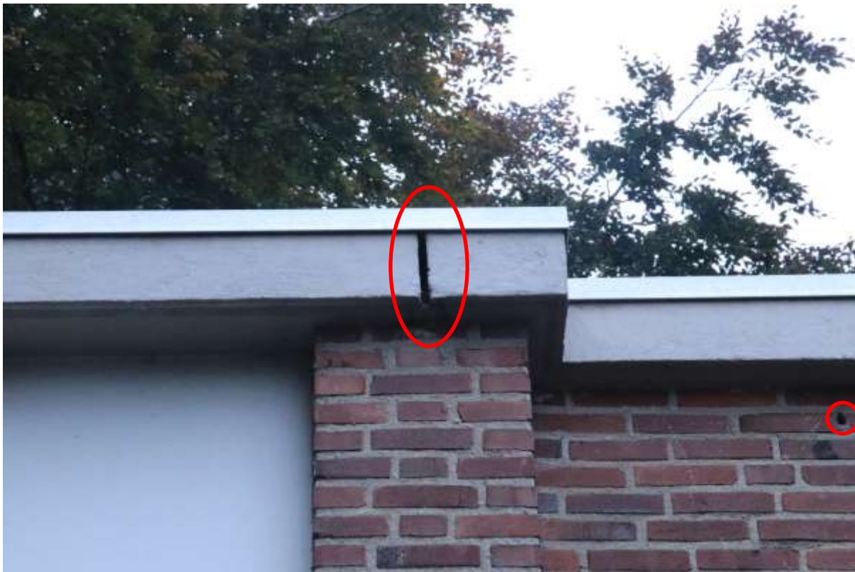
Foto 4: Open stootvoegen en openingen tussen betondelen. Op vele plekken zijn openingen aanwezig voor vleermuizen
